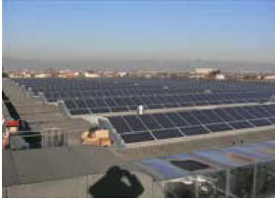
Fig. 68. Le installazioni sulla parte a sud degli shed industriali permettono una buona integrazione del fotovoltaico all'interno dell'edificio e ne sfruttano una parte inutilizzata. ( www.ensun.it )
