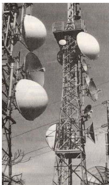
Fig.99. Stazione radio base mista (Consorzio Radio Elettra2000)
