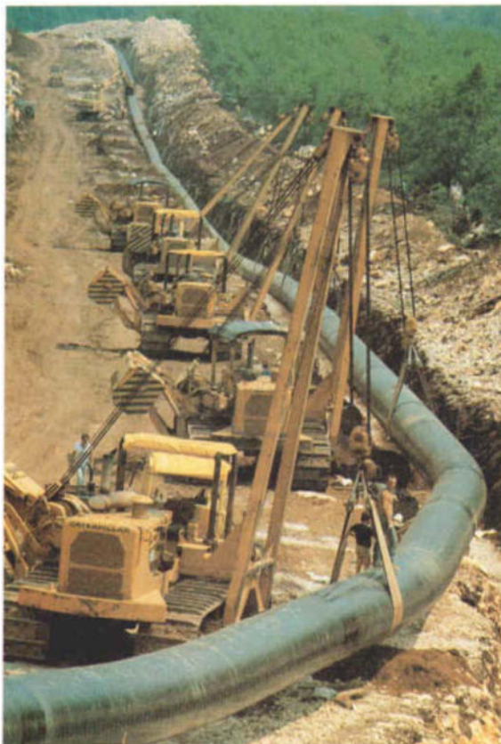
Fig 92. La posa di una condotta interrata comporta evidenti impatti dovuti alle operazioni di scasso e scavo. E' importante già in fase progettuale pianificare le operazioni di ripristino del soprassuolo evitando, comunque, l'attraversamento di zone particolarmente sensibili (www.arpa.emr.it)
