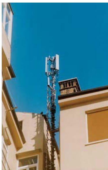
Fig.98. Antenne per la telefonia mobile (www.Calzavara.it)
