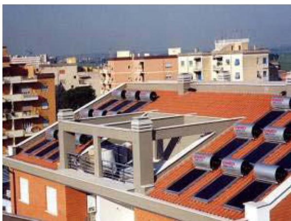
Fig 80. Installazione impianti solari termici, Roma. La forte discromia con l'intorno e il supporto, le dimensioni dei collettori, fanno sì che l'installazione sia di grande impatto visivo sul contesto in cui è inserita.
