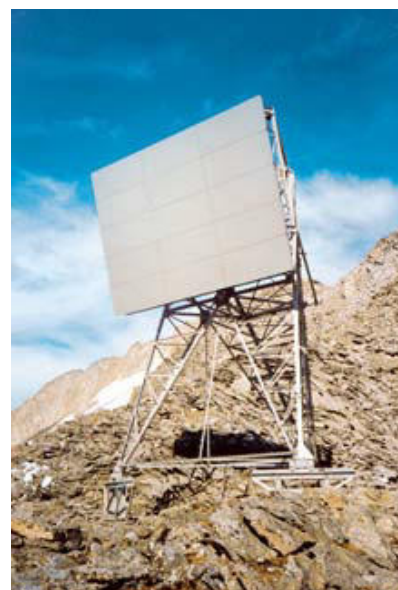
Fig.100. Ripetitore passivo di microonde. (www.Calzavara.it)
