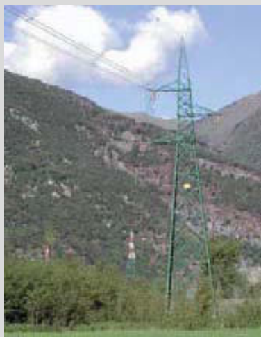
Fig 22. Traliccio di linea ad alta tensione. Si noti come aumenta la visibilità nel caso in cui la parte terminale sia colorata a fasce bianche e rosse per renderli maggiormente visibili ai velivoli.
